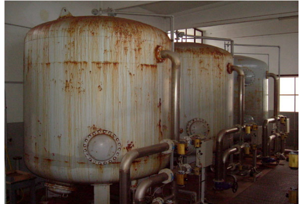
Condición de los Tanques Antes de la Aplicación de la Cinta de Zinc
