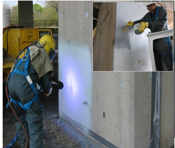
Foto de la instalación de Vector Galvanode ASZ+
